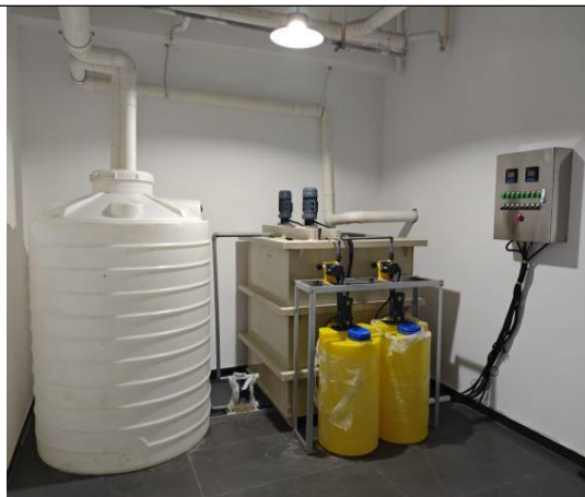
废水处理设备
